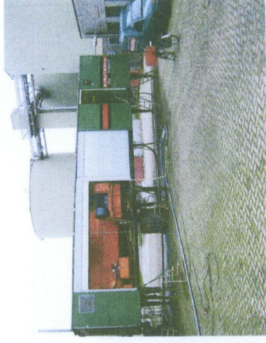
Inzet centrifuge cp 3094 op rwzi Amersfoort i.v.m. reparatie van de eigen installatie (in 6 weken 500 tds).
