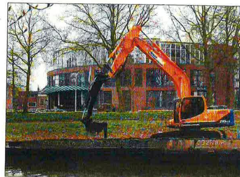
Het meest vervuilde slib wordt afgegraven met een kraan en vanaf een vlot in vrachtwagens geladen en afgevoerd.
